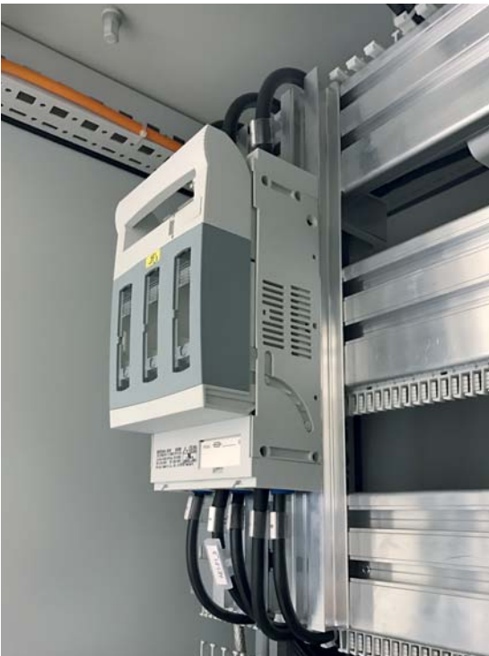
Abb. 1: Hauptschalter auf RG035.
