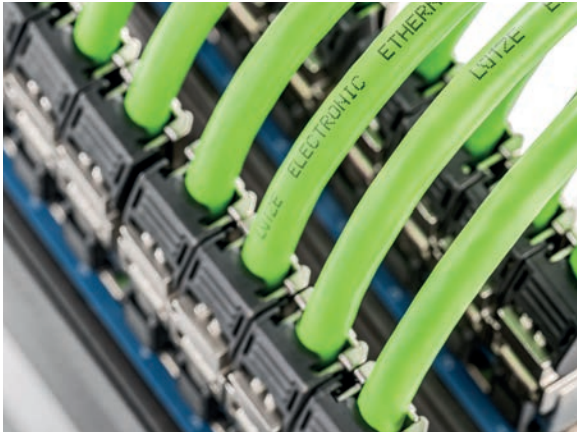
Netzwerk- und Busleitungen
