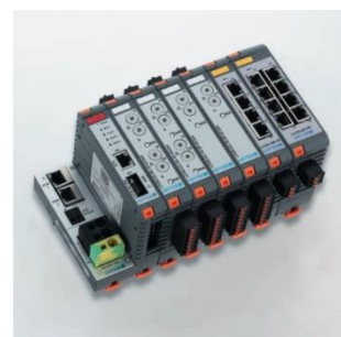
LCOS-System mit Einspeisung, Buskoppler, LCOS-CCI und Switches
